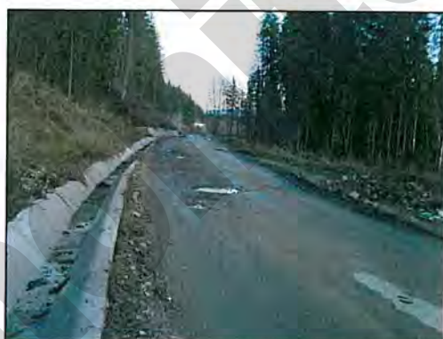
Degradări la sistemul rutier
